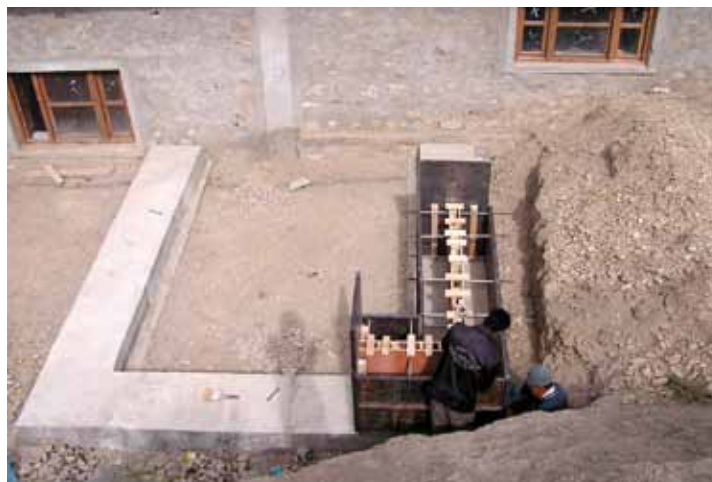
ZKUŠEBNÍ BUDOVA; HUTNĚNÍ PRVNÍ VRSTVY STĚNY DO BEDNĚNÍ; DO MEZERY V DVOJITÉ ZDI JE VLOŽENA IZOLACE.
