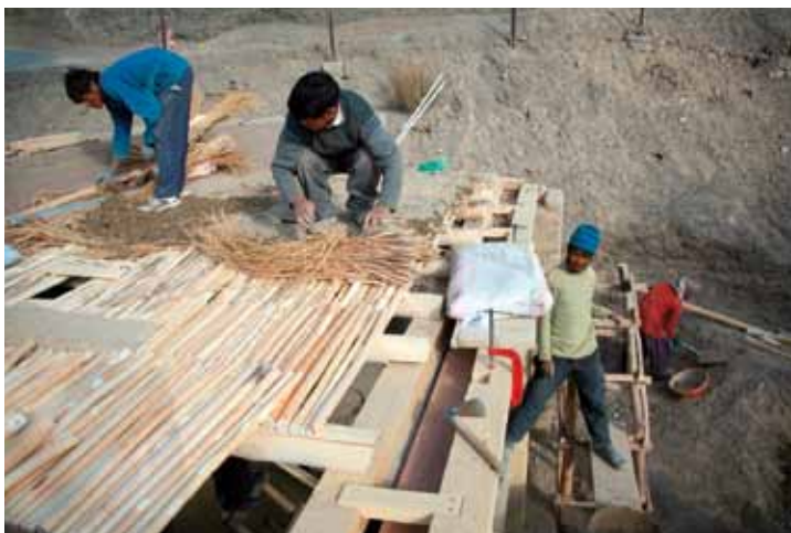
ZKUŠEBNÍ BUDOVA; POKLÁDÁNÍ STŘEŠNÍHO SOUVRSTVÍ; LIMITOVANÁ MECHANIZACE A NÁRADÍ A OBTÍŽNÁ KONTROLA KVALITY SI VYNUITLY JEDNODUCHÉ KONSTRUKCE A POSTUPY.
